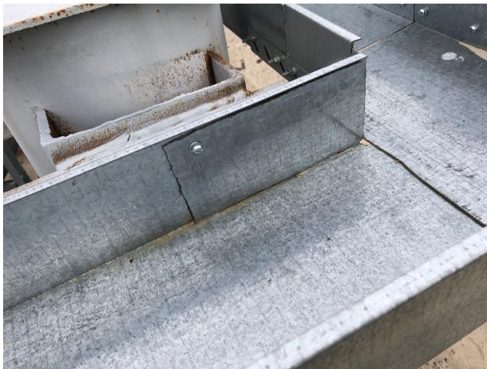
Рис.16. Несоответствие фактически смонтированной секции угловой 90 грд. данным указанным в акте КС-2 № 1 от 05.08.2018. Фактически секция выполнена самодельно силами подрядчика из металлических штампованных листов.
