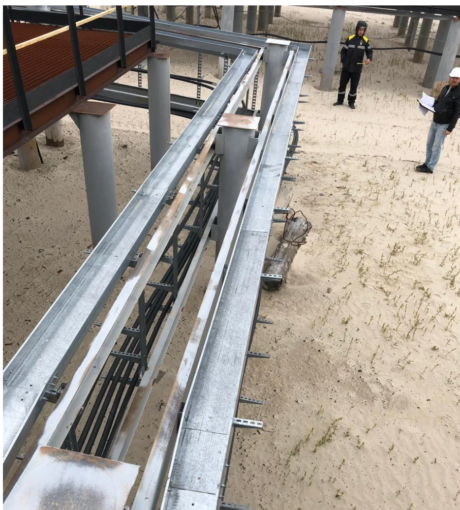
Рис.11. Отсутствуют крышки кабельных лотков. Площадка КТПМ, отходящая кабельная эстакада.
