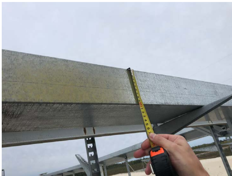
Рис.9. Несоответствие размеров (100 мм) фактически смонтированного кабельного лотка, требованиям сметной документации и не соответствию размерам указанным в акте КС-2 № 1 от 05.08.2018 (160 мм) листового перфорированного лотка. Кабельная эстакада в р-не АГЗУ-1.
