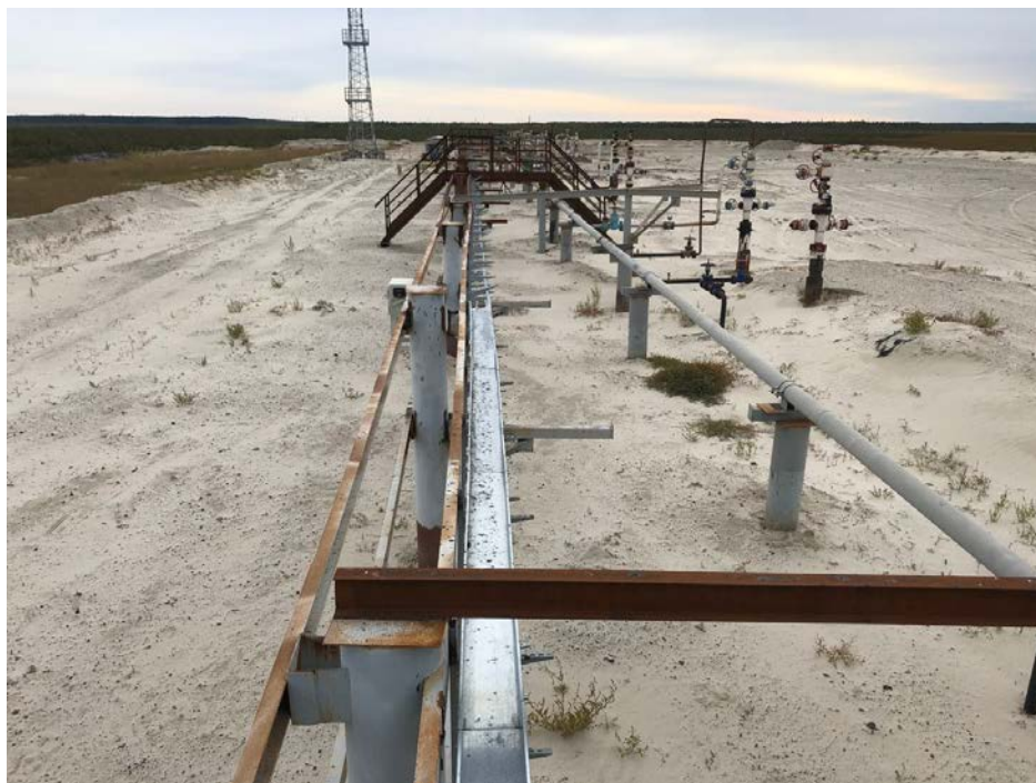
Рис.12. Отсутствуют крышки кабельных лотков. Кабельная эстакада в р-не скважины № 1.
