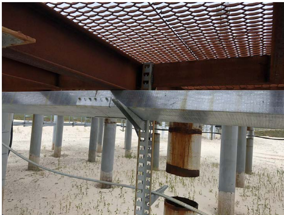
Рис.14. Выявлено несоответствие высоты монтажа кабельного лотка. Площадка ТМПП и СУ.
