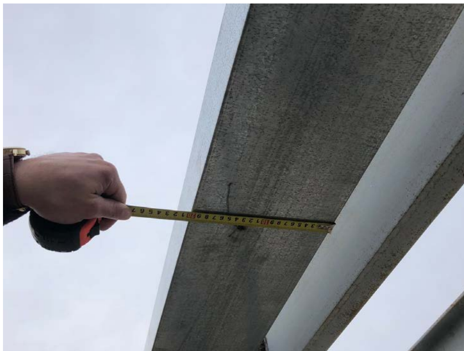
Рис.8. Несоответствие размеров (200 мм) фактически смонтированного кабельного лотка, требованиям сметной документации и не соответствию размерам указанным в акте КС-2 № 1 от 05.08.2018 (300 мм) листового перфорированного лотка. Кабельная эстакада в р-не АГЗУ-1.
