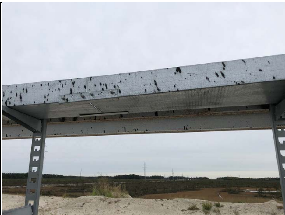
Фото №19. Лоток листовой 200х100. Кабельная эстакада в р-не скважины № 1.
