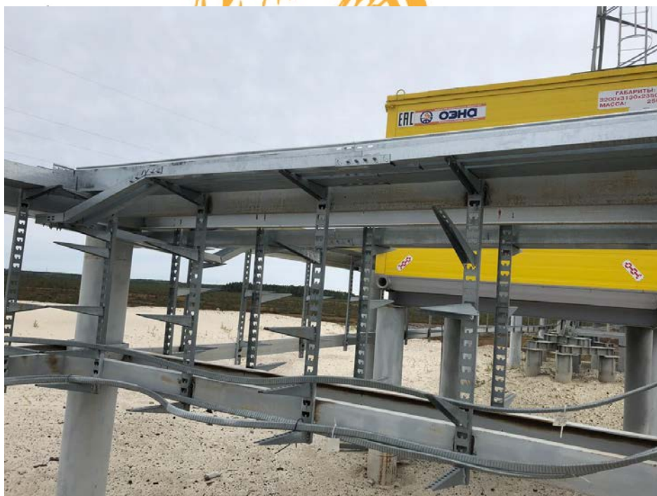
Рис.15. Отсутствует заземление кабельных лотков. Кабельная эстакада в р-не БА-1.
