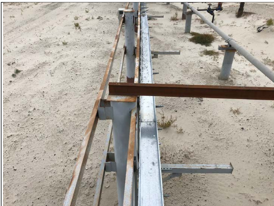
Фото.№1. Лоток листовой 200х100. Кабельная эстакада в р-не скважины № 1.
