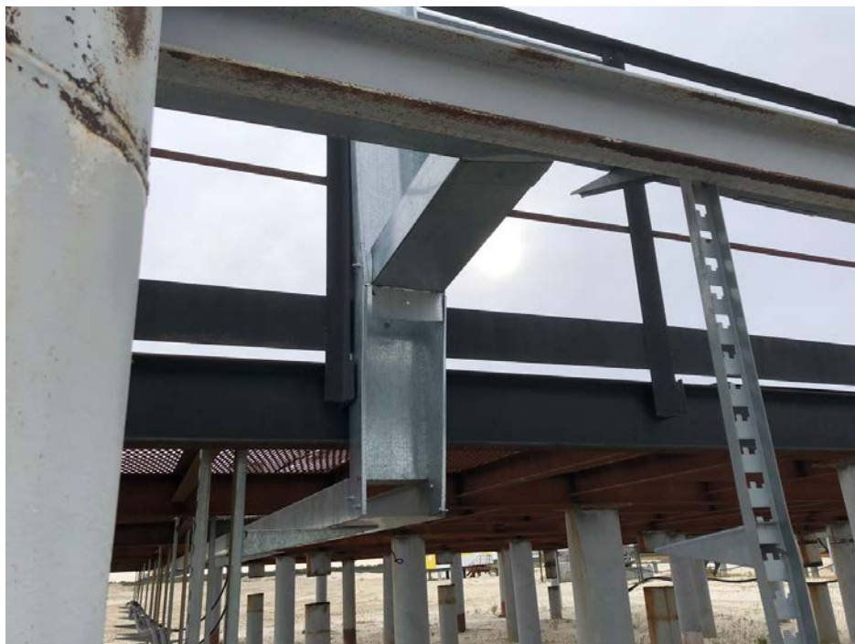
Рис.10. Отсутствует крепление кабельного лотка на подъёме. Площадка ТМПН и СУ.
