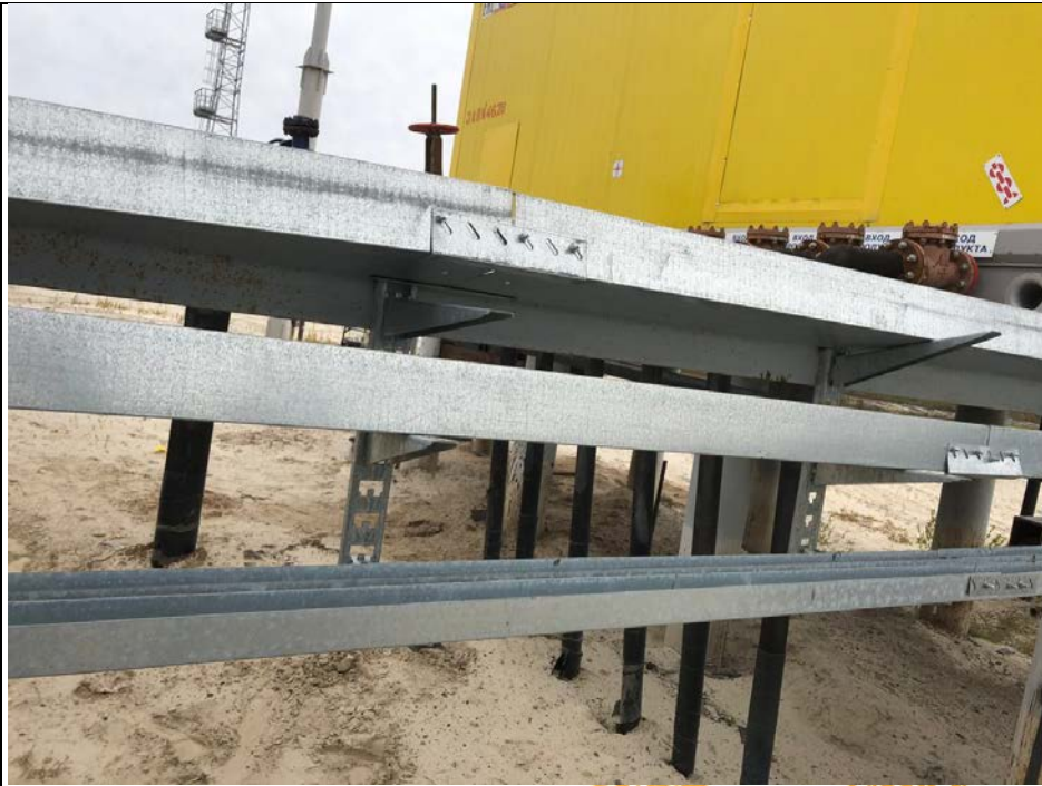
Фото №15. Лоток листовой 200х100. Отпайка от кабельной эстакады до АГЗУ-1.
