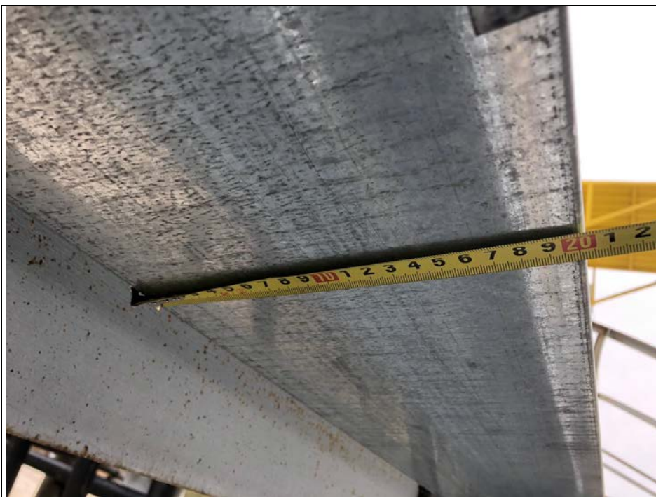
Фото №13. Лоток листовой 200х100. Кабельная эстакада в р-не АГЗУ-1.
