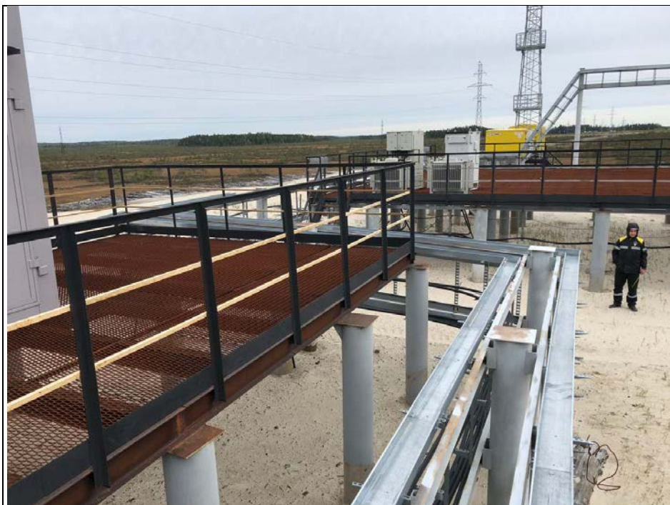
Фото №3. Лоток листовой 200х100. Площадка КТПМ, отходящая кабельная эстакада.
