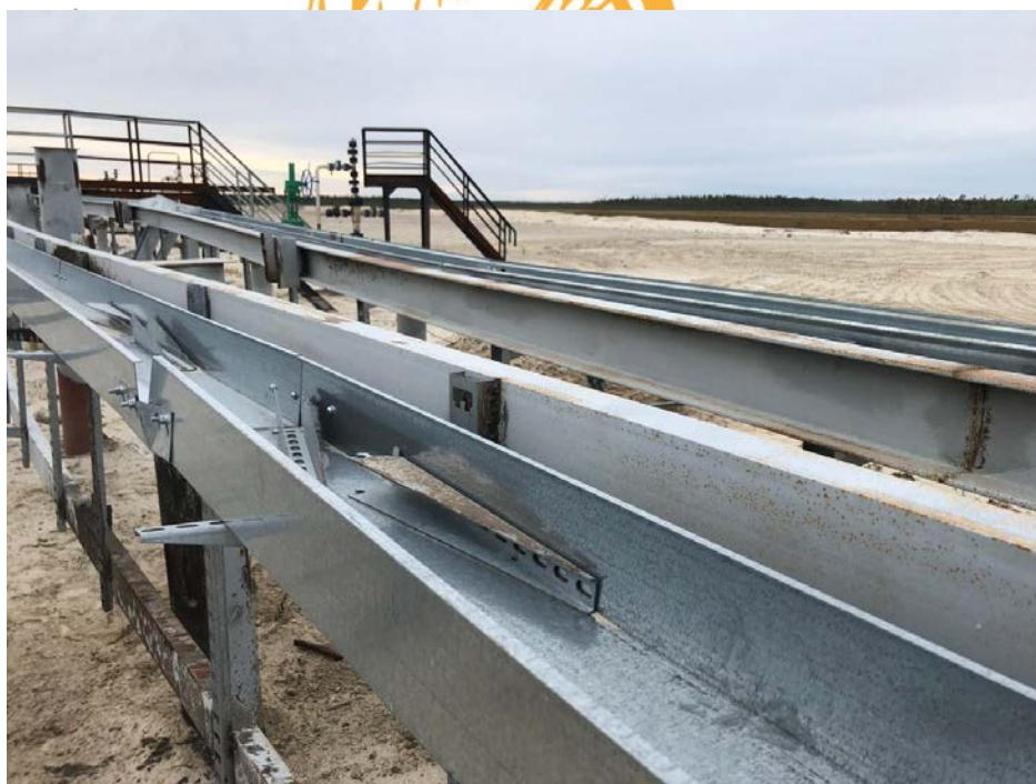
Рис.13. Выявлены повреждения кабельных лотков (отсутствие стенок лотков, повреждение лотков). Кабельная эстакада в р-не скважины № 1.
