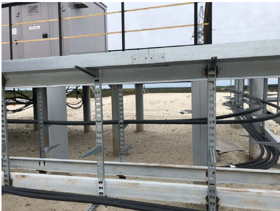
Рис.3. Общий вид кабельного лотка. Площадка КТПМ отходящая кабельная эстакада.
