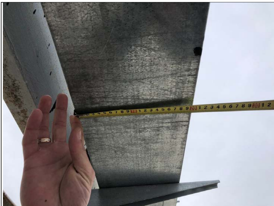
Фото №17. Лоток листовой 200х100. Отпайка от кабельной эстакады до АГЗУ-1.
