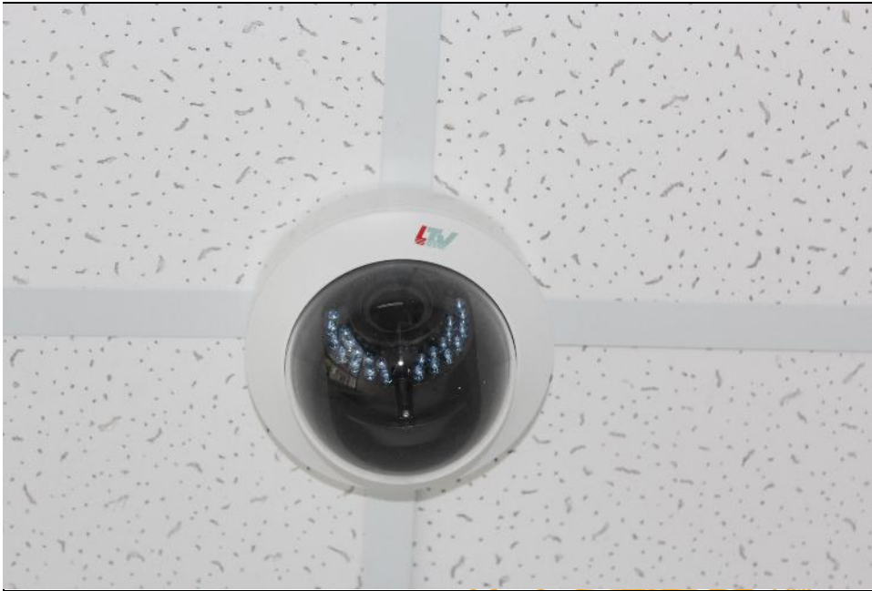
Фото№30. Купольная видеокамера системы видеонаблюдения.
