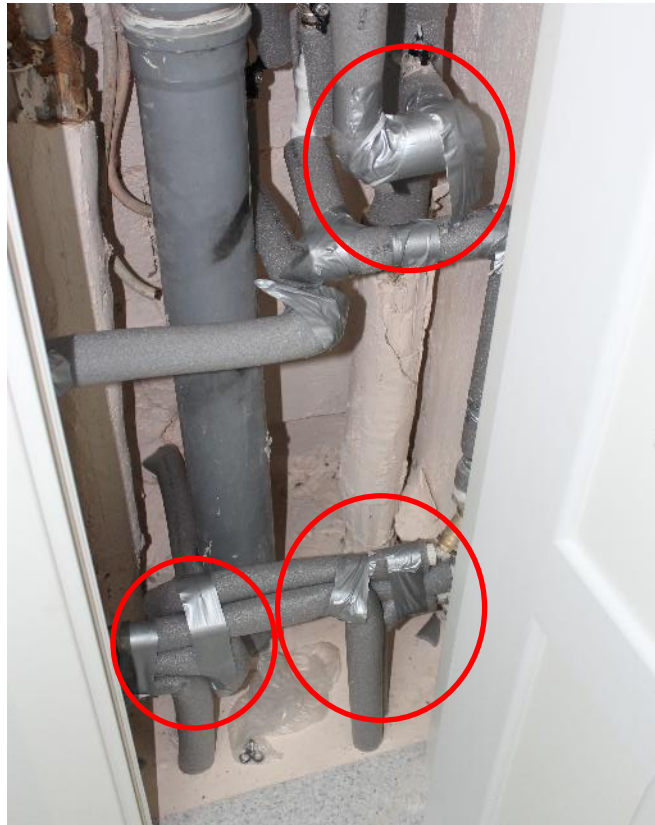
Рис. № 14. Не качественно выполненный монтаж теплоизоляционного покрытия.
