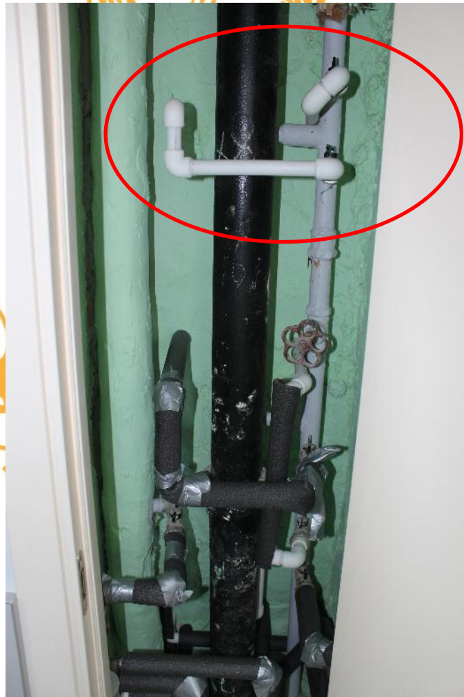
Рис. № 15. Не законченный монтаж теплоизоляционного покрытия.
