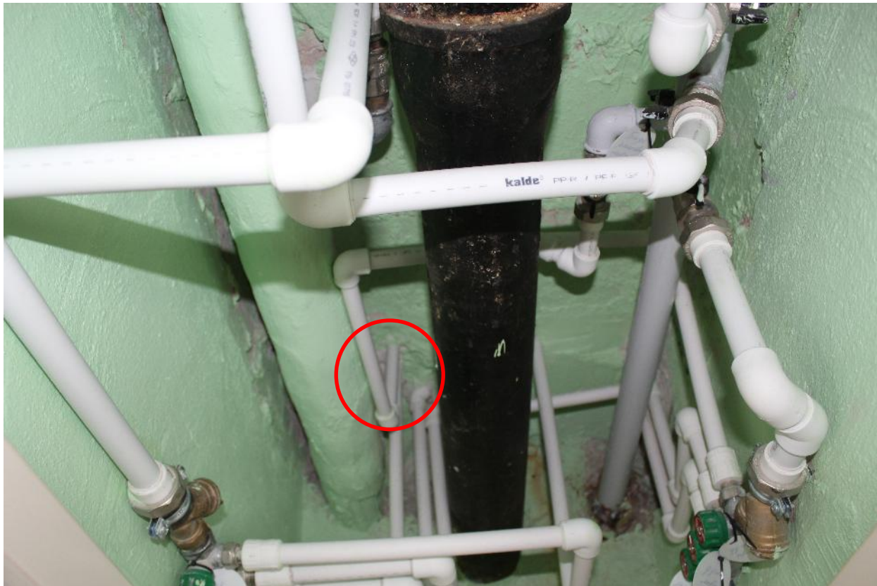
Рис. № 4. Отсутствие стальных гильз.
