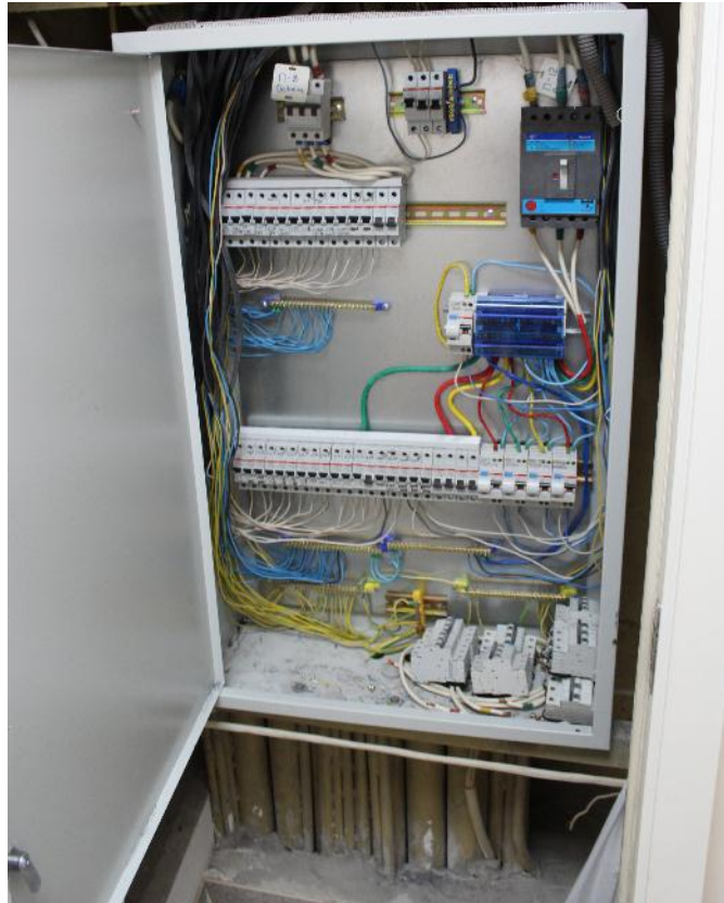
Рис. № 18. В электрощитах отсутствуют однолинейные схемы.
