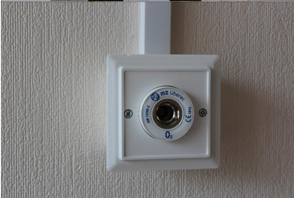
Фото№32. Разъём подачи кислорода системы подачи медицинских газов.
