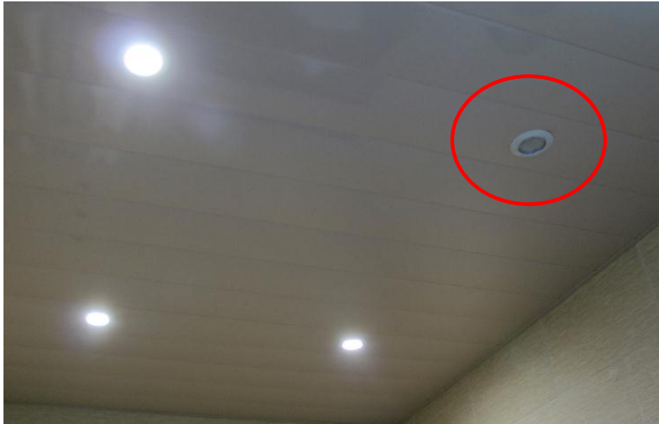
Рис. № 23. Не работающая лампочка.
