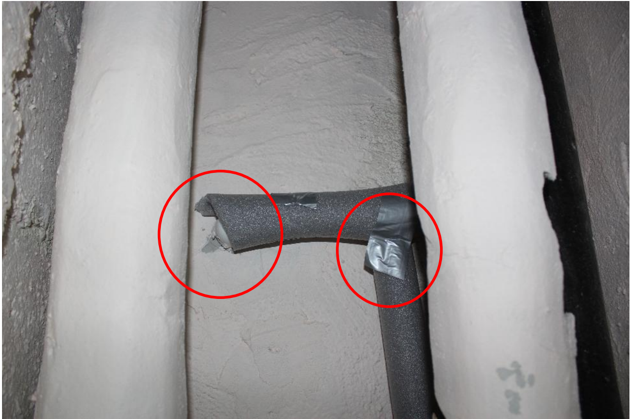
Рис. № 12. Не качественно выполненный монтаж теплоизоляционного покрытия.
