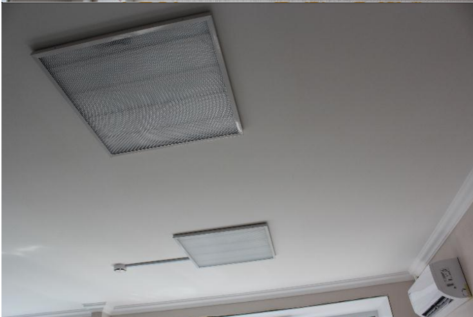
Фото№29. Смонтированные светильники.
