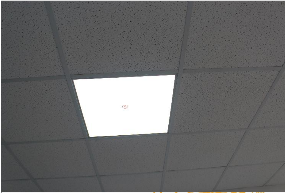
Фото№21. Аварийный светильник.
