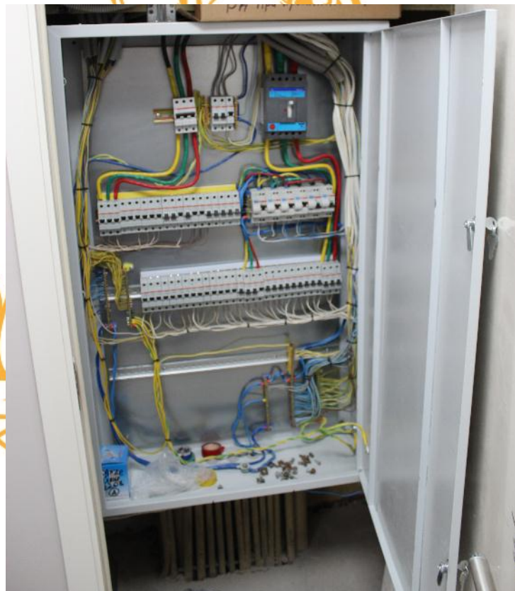
Рис. № 19. В электрощитах отсутствуют однолинейные схемы.
