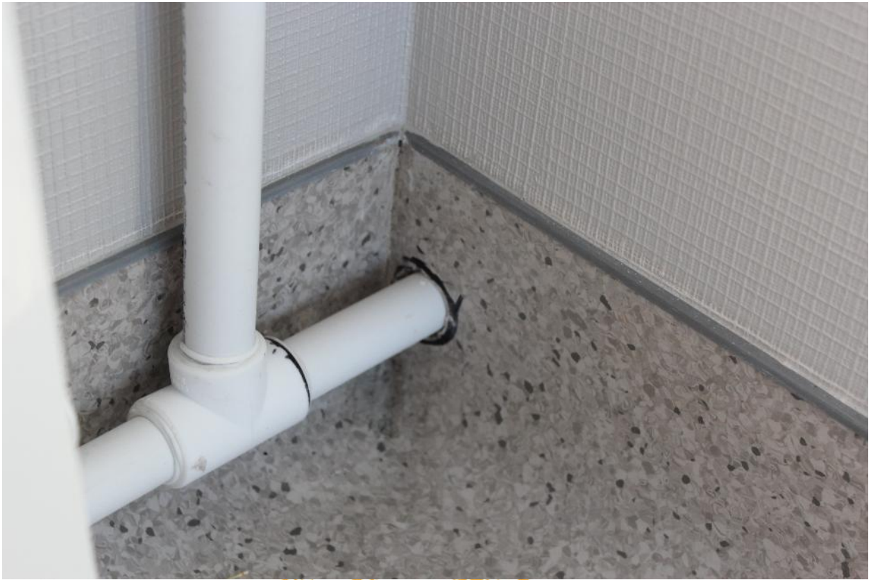
Рис. № 8. Отсутствие стальных гильз.
