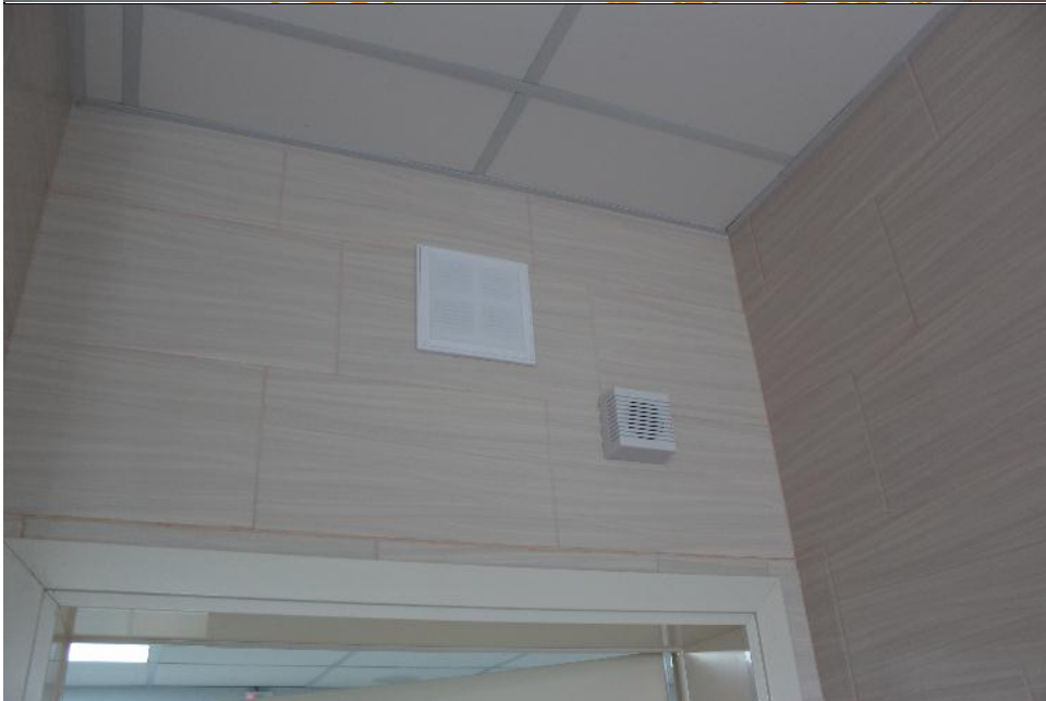
Фото№23. Смонтированная вентиляционная решетка и громкоговоритель.
