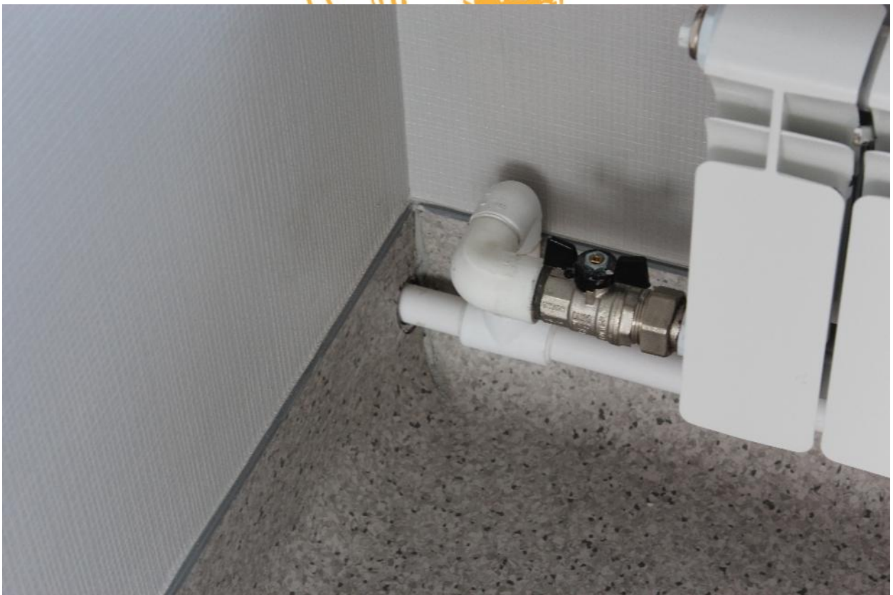
Рис. № 9. Отсутствие стальных гильз.
