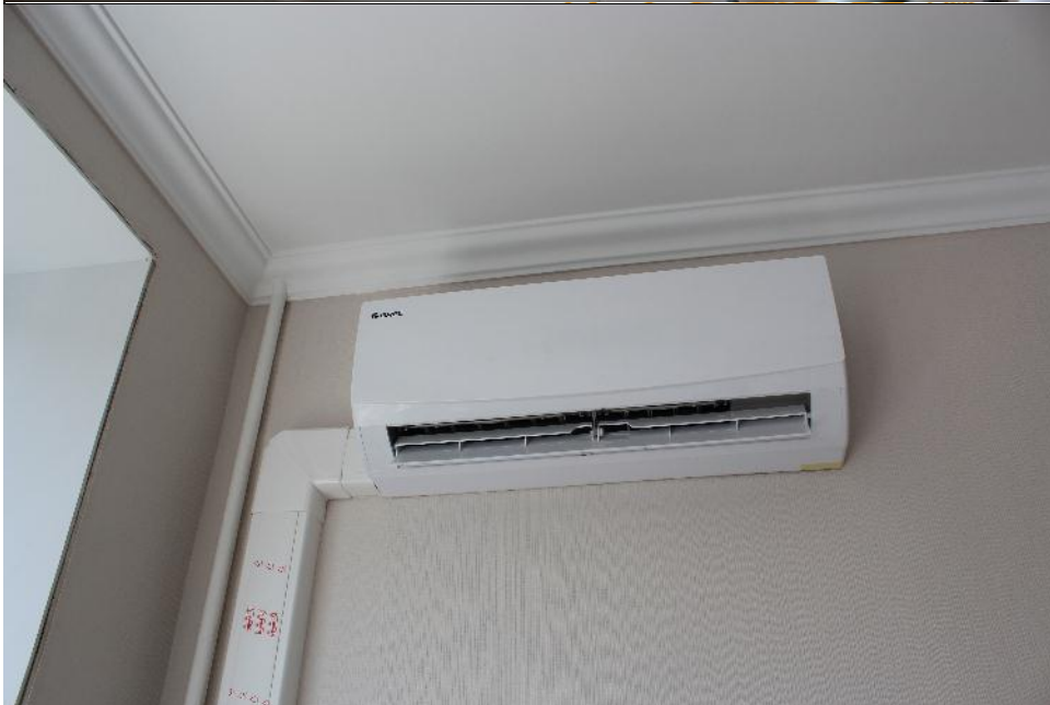
Фото№28. Внутренний блок сплит системы.
