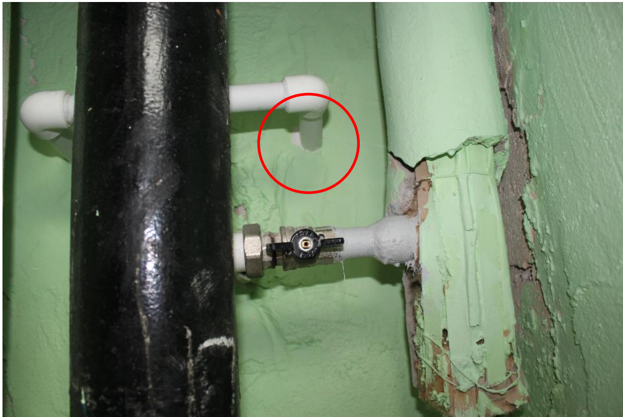
Рис. № 2. Отсутствие стальных гильз.
