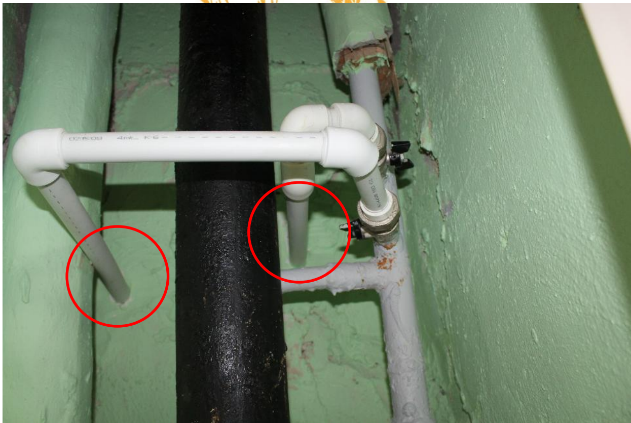
Рис. № 3. Отсутствие стальных гильз.
