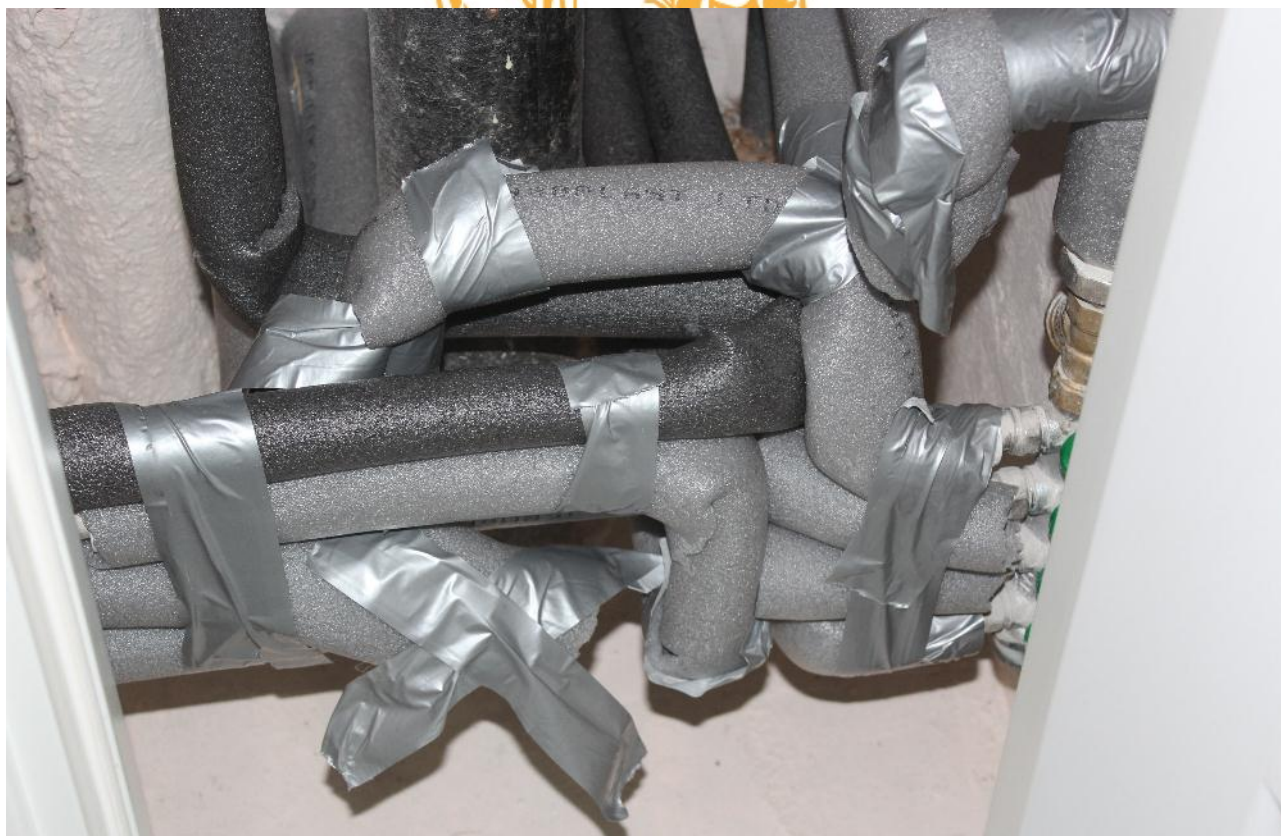
Рис. № 11. Не качественно выполненный монтаж теплоизоляционного покрытия.
